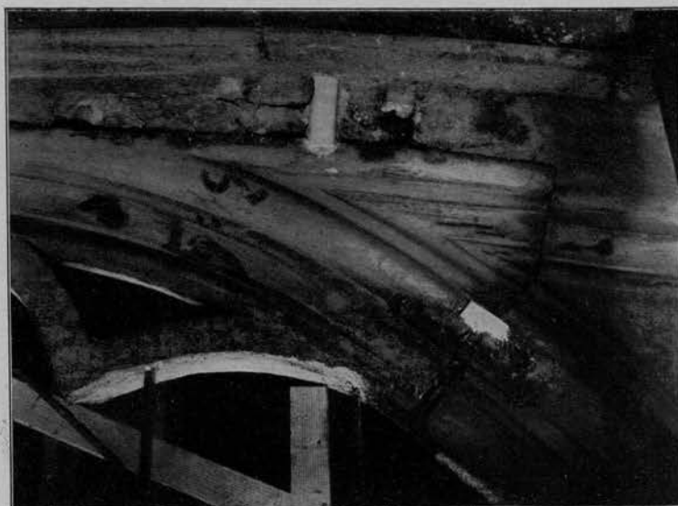
Fig. 49 - S. Gio. e Paolo. Grande finestrone. Particolare dello stato della parte lapidea prima del restauro.
