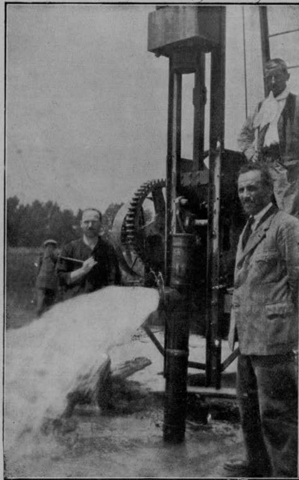
Fig. 5. — Pozzo di Mondello Vitta (Novara) - Portata di 1000 litri al 1' - Ditta Fr. ed A. Bertone.
